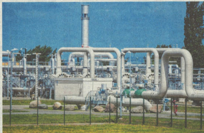
Sollte die Regierung das Energiesicherungsgesetz aktivieren, dürften Gasversorger quasi sofort alle Verträge kündigen und ihre Preise erhöhen. BILD: STEFAN SAUER/DPA
